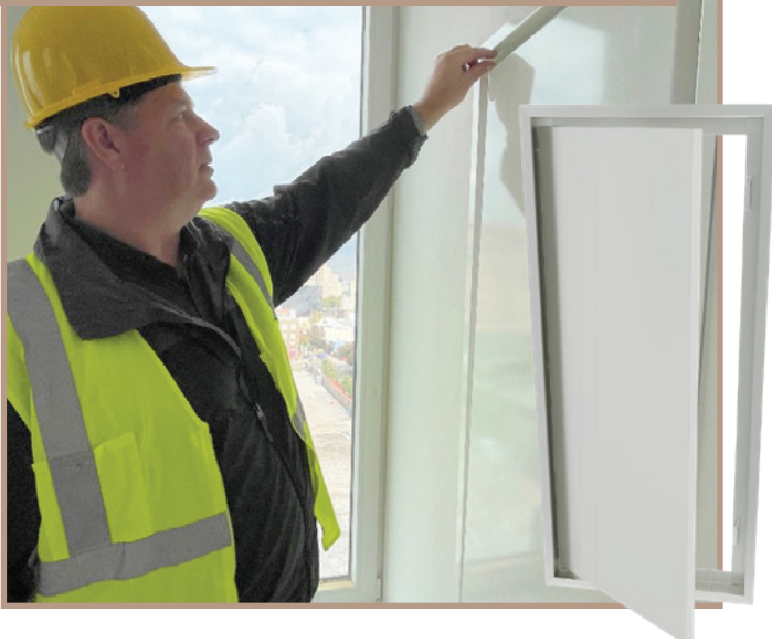
PAR Perimeter Air Return Door
